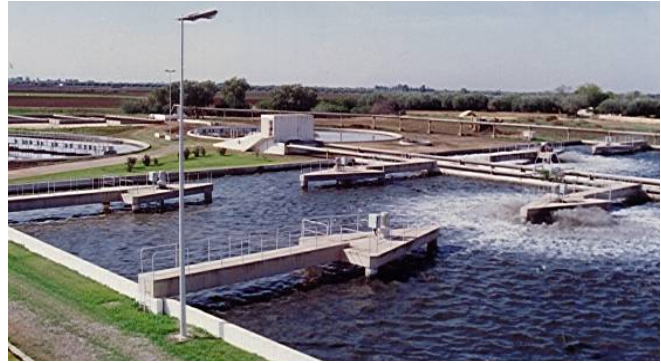
الشكل 26 : محطة معالجة المياه الصادمة ببني ملال
