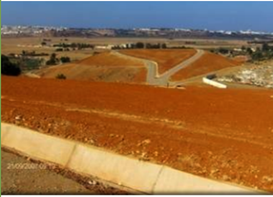
الشكل 27 : محطة معالجة مياه الصرف الصحي بتاوجطات
